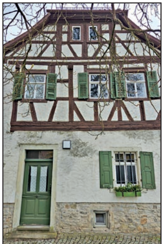
Vergrauter, schadhafter Putz und abblätternde Farbe an den Fenstern und Läden – die Fassade des Fröhmeserhauses soll renoviert werden.
